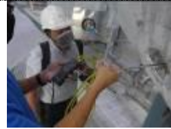
風機壓差量測
